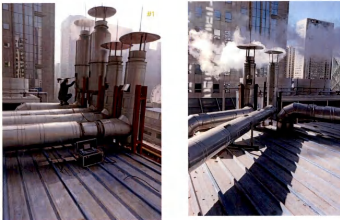
图 4-2 天然气锅炉排气筒照片
